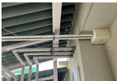
【温水配管接続部(特別教室棟)】
