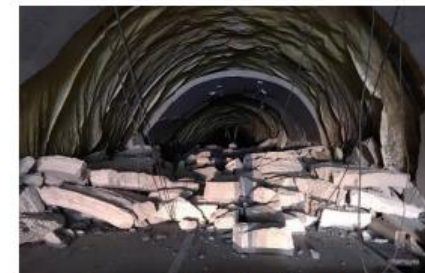
トンネル崩壊 (国道249号)
