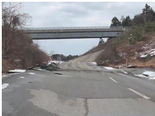
幹線道路の不陸（輪島市）
