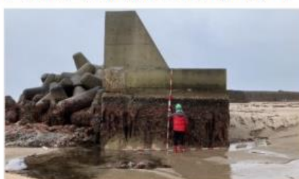
地盤隆起 (鹿磯漁港 (輪島市))
