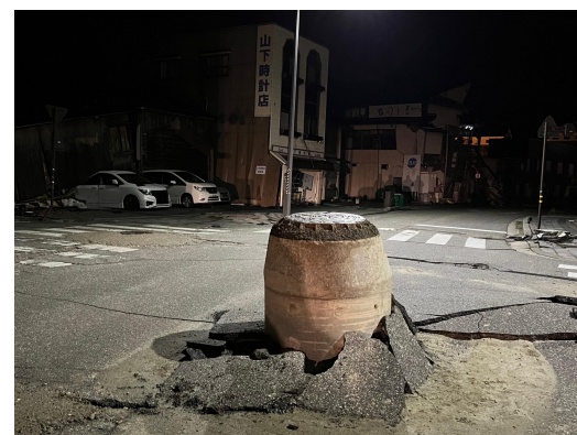
マンホールの隆起（輪島市）
