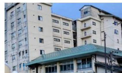
建物損壊 (和倉温泉 (七尾市))
