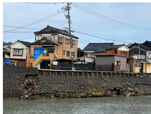
河川護岸の崩落（輪島市）
