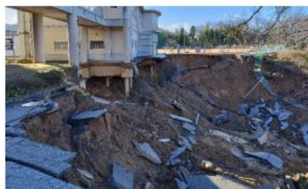
法面崩壊 (金沢北陵高校 (金沢市))
