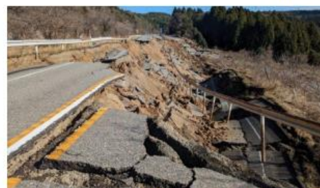
道路被害 (のと里山海道 横田IC付近)
