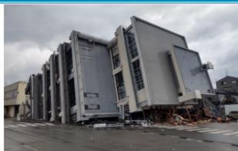
建物倒壊 (輪島市河井町地内)
