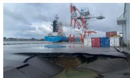
ふ頭用地陥没 (金沢港 (金沢市))
