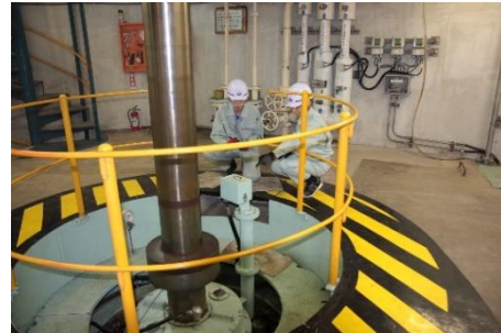
現場(徳山発電所)で水車の点検作業を行っているところ
