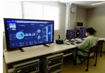
制御室でポンプの運転状態を遠隔で監視、操作を行っているところ
