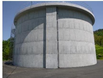
ファームポンド (PCタンク)
