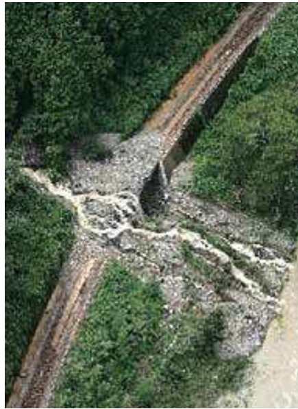
錦川鉄道の土砂崩れ
