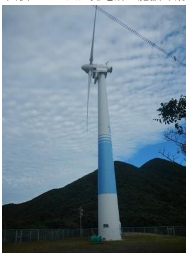
図表 4-24 風力発電所の施設外観
