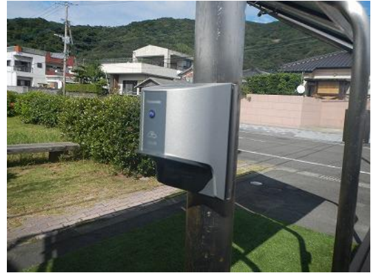
コンセント部分
