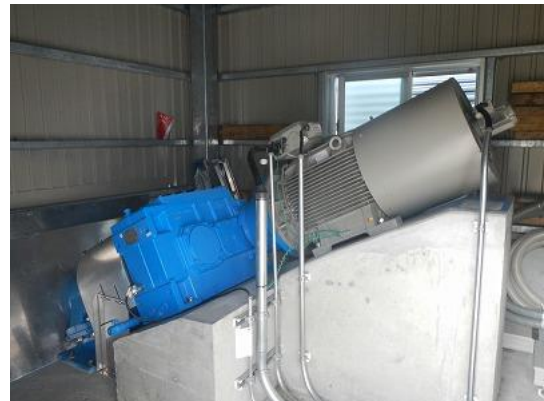
発電機（増速機により回転数を約1000回転/分まで上昇させる）
