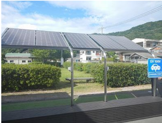
太陽光パネル&蓄電池 (ベンチ下にバッテリーを設置)
