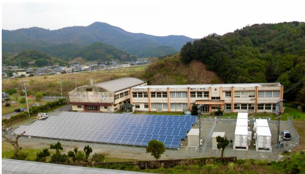
図表 4-18 甌島蓄電センター／甌島・浦内太陽光発電所 外観
