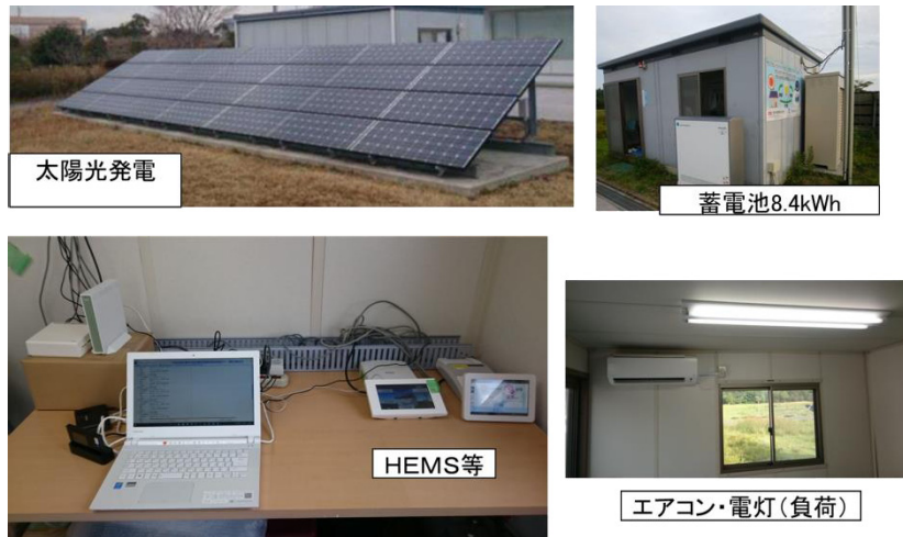
図表 4-4 山口県産業技術センター試験場の施設写真
