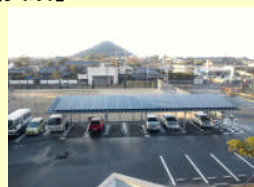
太陽光パネル
