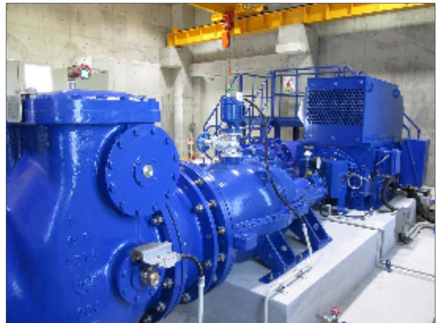
ポンプ、屋内配管
