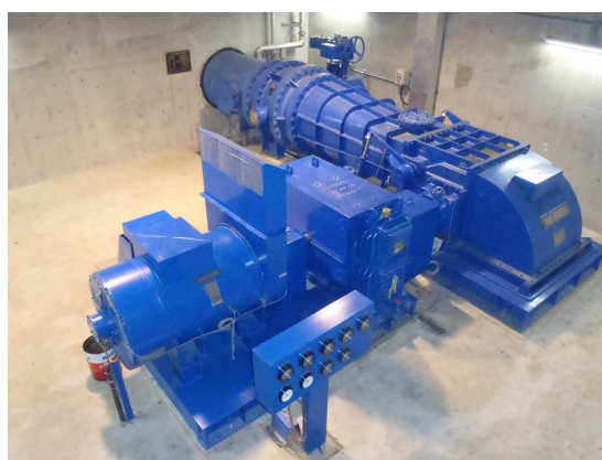
《小瀬川発電所 水車発電機》
