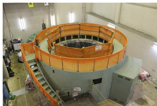
新阿武川発電所
