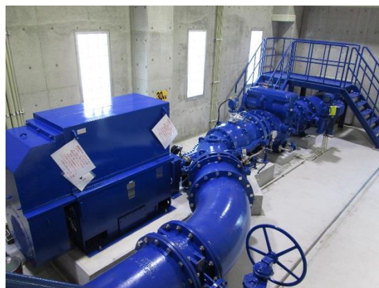
宇部丸山ダム送水ポンプ場
