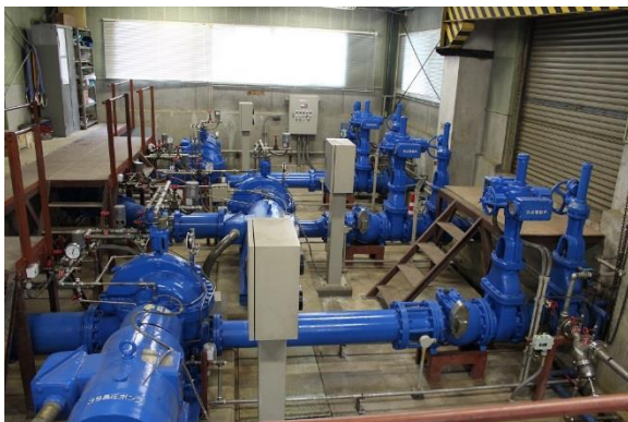
古祖原ポンプ場
