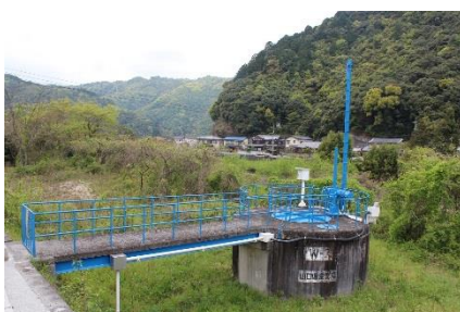
小瀬川工業用水道接合井
