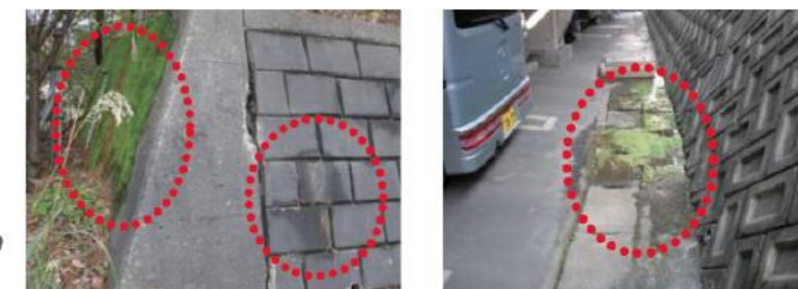
水がしみだしている擁壁 湧水部分にコケが生えている擁壁 (提供：社団法人 全国宅地擁壁技術協会)
