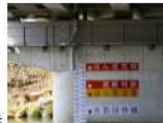
橋脚等への目印により河川水位の情報を表示
