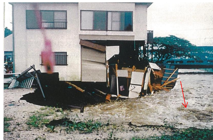
平成5年8月2日：切戸川（国道188号バイパス上流側）
