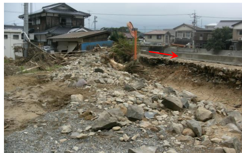
平成25年7月28日：龍背橋付近の被害状況
