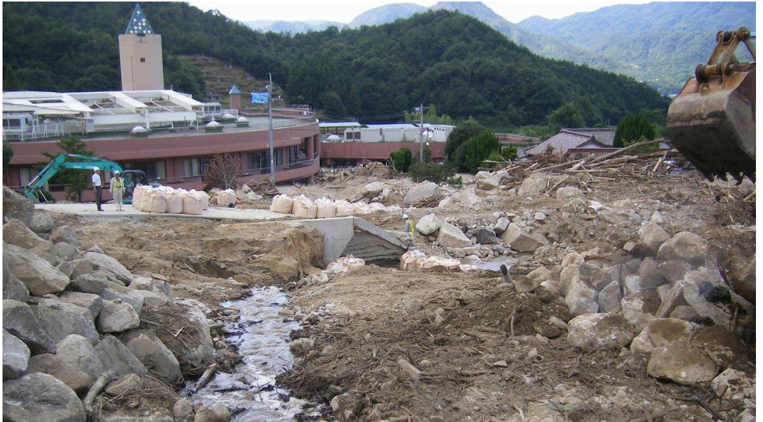
老人ホームを直撃した土石流 平成21年(2009年)7月21日の豪雨 防府市
