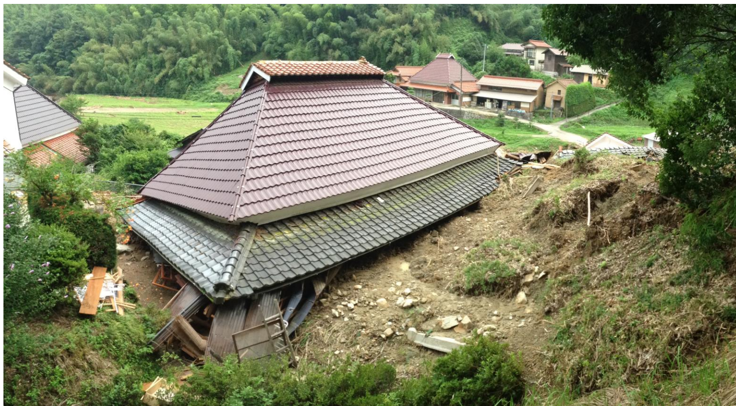
がけ崩れ発生状況 平成25年(2013年)7月28日の豪雨 萩市
