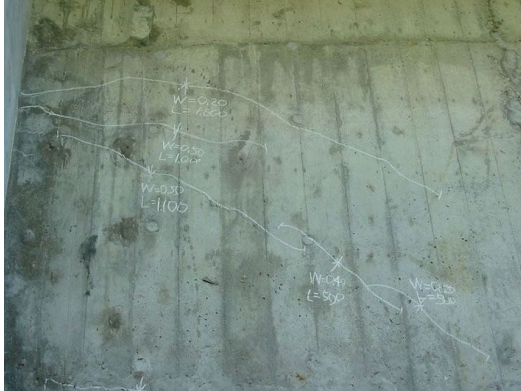
幅 0.2～0.5mm の方向性のあるひびわれ 東側主桁側面端部付近において、幅 0.2mm～0.5mm の方向性のあるひびわれが数条認められる。 【損傷ランク II】
