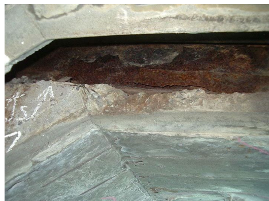
ウェブプレートの腐食
