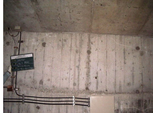
幅 0.2mm～1.1mm の方向性のあるひびわれ(端横桁) A1 主桁端部において、東側側面～端横桁～西側側面にかけて連続する方向性のあるひびわれが、教条認められる。【損傷ランクⅡ】
