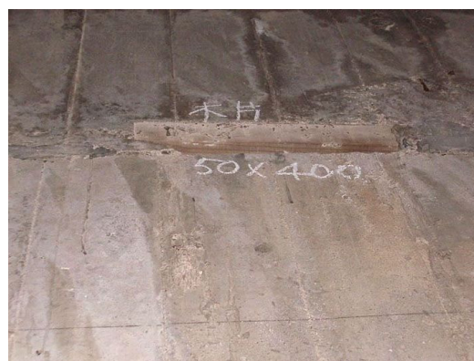
コンクリート表面剥離部に木片混入 西側側面部において、型枠片と推測される木片の混入が認められる。【損傷ランクⅣ】
