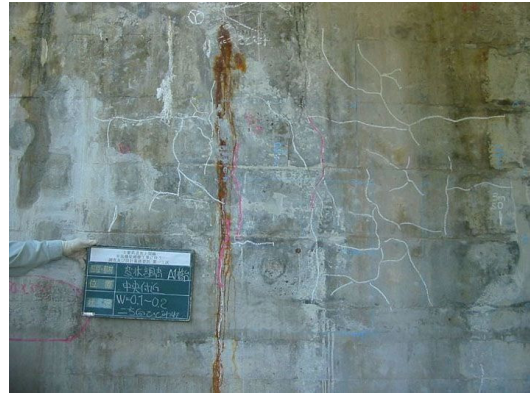
ASRの影響と推測される方向性のないひびわれ たて壁部において、ASRの影響と推測される幅0.1～0.2mmの方向性のないひびわれ及び錆汁が、認められる。【損傷ランクⅡ】
