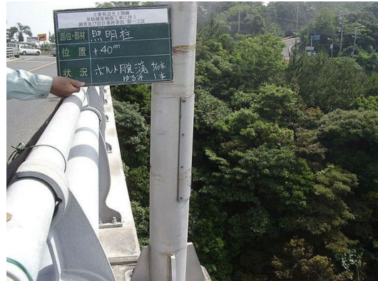
カバーボルトの脱落及びゆるみ
