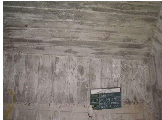
幅 0.5mm～1.2mm の方向性のあるひびわれ(端横桁) A2 主桁端部において、東側側面～端横桁～西側側面にかけて連続する方向性のあるひびわれが、教条認められる。【損傷ランクⅡ】
