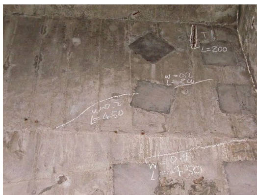
幅 0.2～0.4mm の方向性のあるひびわれ 東側主桁側面端部付近において、幅 0.2mm～0.4mm の方向性のあるひびわれが数条認められる。【損傷ランクⅡ】
