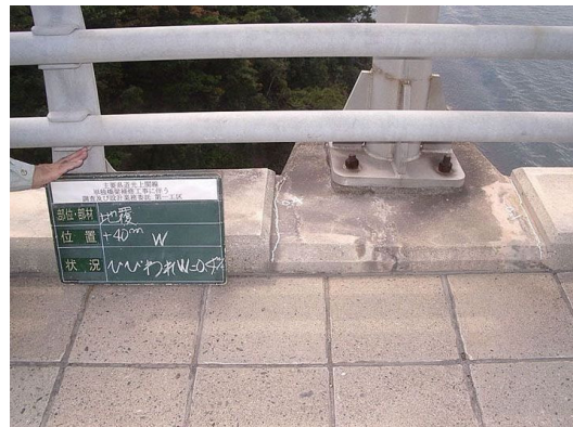
幅 0.4mm の橋軸直角方向ひびわれ P1 西側照明柱取付部付近において、認められる。 【損傷ランクⅢ】
