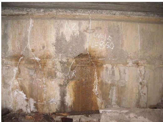
漏水及び遊離石灰を伴うひびわれ たて壁部において、幅 0.2mm～1.0mm の一方向ひびわれが数条認められ、一部においては、漏水及び遊離石灰が認められる。【損傷ランク II】
