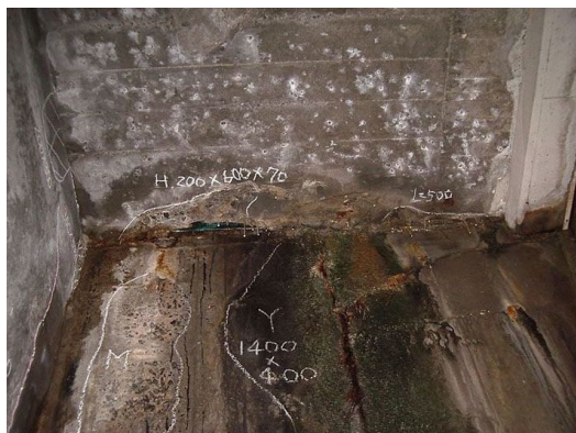
橋面伸縮装置からの水の流出に伴う遊離石灰 東側張出床版端部付近において、降雨時には、橋面伸縮装置から水の流出が顕著に認められ、遊離石灰も認められる。また、同位置には、剥離、鉄筋露出も認められる。【損傷ランクⅡ、Ⅲ】
