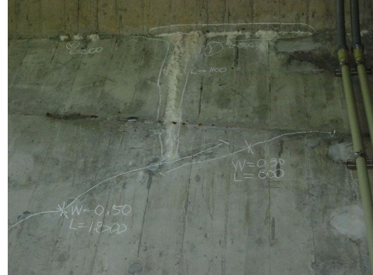
幅 0.3～0.5mm の方向性のあるひびわれ 西側主桁側面端部付近において、幅 0.3mm～0.5mm の方向性のあるひびわれが数条認められ、ハンチ部においては、遊離石灰が認められる。 【損傷ランク II、III】
