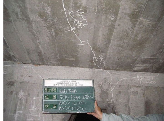
幅 0.2mm の橋軸直角方向ひびわれ 中央部 P2 側上面において、橋軸直角方向のひびわれが認められる。【損傷ランク II】
