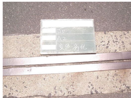
伸縮ゴムの劣化 A2鋼重ねせジョイントにおいて、遊間部の全体的なゴムの劣化が認められる。【損傷ランクⅣ】
