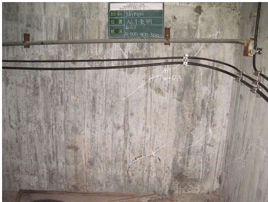
幅 0.3mm の方向性のあるひびわれ(西側側面) A1 主桁端部において、東側側面～端横桁～西側側面にかけて連続する方向性のあるひびわれが、教条認められる。【損傷ランクⅡ】
