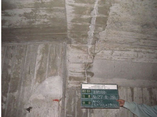
幅 0.2mm の橋軸直角方向ひびわれ 中央部 P1 側上面において、遊離石灰を伴う橋軸直角方向のひびわれが認められる。【損傷ランク II】
