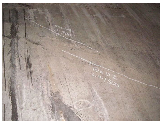
幅 0.2～0.4mm の方向性のあるひびわれ 西側主桁側面端部付近において、幅 0.2mm～0.4mm の方向性のあるひびわれが数条認められる。【損傷ランクⅡ】
