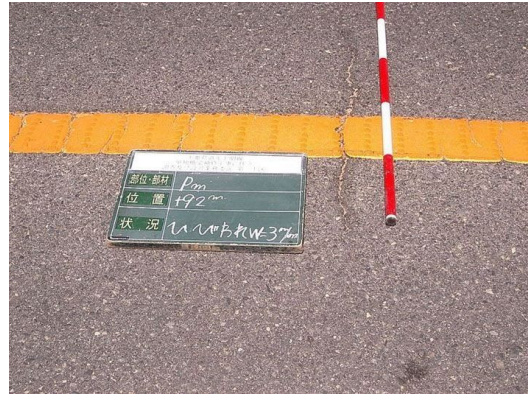
車道部：橋軸直角方向ひびわれ A1-A2 間散在して認められる。 主に車道中央部に認められる。 【損傷ランクⅣ】
