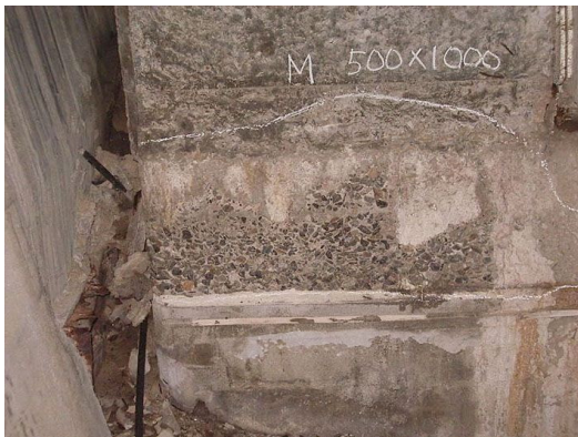
コンクリート表面剥離による粗骨材の露出 たて壁部において、粗骨材の露出が広範囲に認められる。【損傷ランク II】
