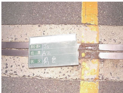
フェイスプレートの腐食 A2鋼重ねせジョイントの車道中央部において、鋼材の局所的な断面欠損を伴う腐食が、認められる。【損傷ランクⅢ】
