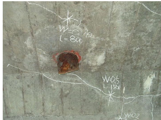
排水パイプの腐食
