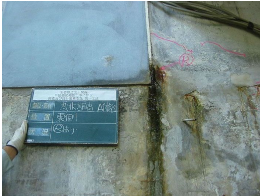
コンクリート打継部からの漏水 教箇所を設置されている導水管及び打継部において、晴天時でも水のしみ出しが認められる。【損傷ランクⅡ】
