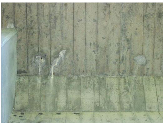
水抜き穴からの遊離石灰 東側張出床版端部付近において、水抜き穴からの遊離石灰が教箇所認められる。【損傷ランクⅢ】
