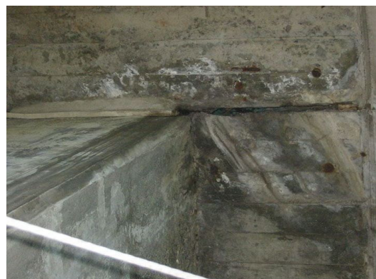
橋面伸縮装置からの水の流出に伴う遊離石灰 西側張出床版端部付近において、降雨時には、橋面伸縮装置から水の流出が顕著に認められ、遊離石灰も認められる。【損傷ランクⅢ】
