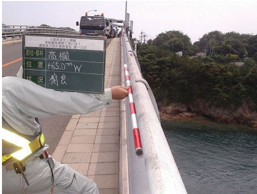
高欄上部パイプの表面錆
