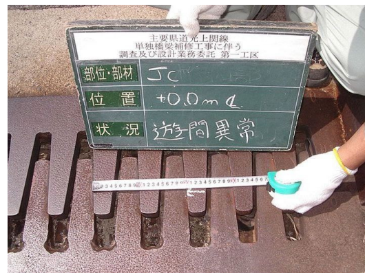
フィンガージョイントの遊間異常 中央部フィンガージョイントの西側において、フィンガー部の接触が認められる。【損傷ランクⅡ】
