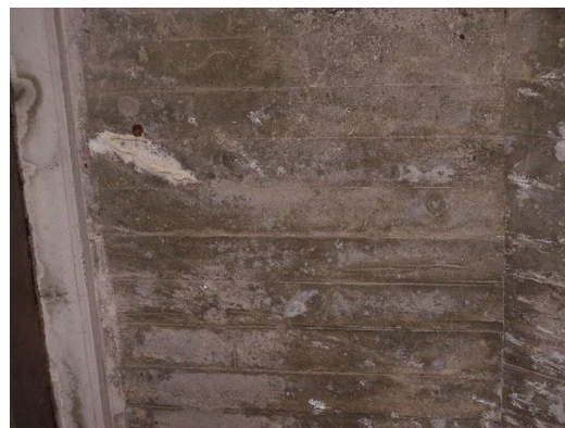
ひびわれからの軽微な遊離石灰 西側張出床版端部付近において、ひびわれからの軽微な遊離石灰が認められる。【損傷ランクⅢ】
