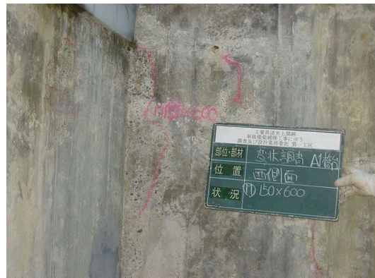
豆板、空洞 西側側面において、小規模ではあるが、豆板、空洞が3箇所認められる。【損傷ランクⅣ】
