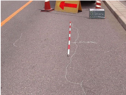
車道部：橋軸方向ひびわれ A1-A2 間散在して認められる。 主に輪重のかかる位置に認められる。 【損傷ランクⅣ】
