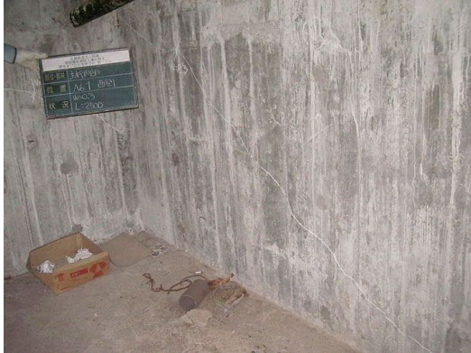
幅 0.3mm の方向性のあるひびわれ(東側側面) A1 主桁端部において、東側側面～端横桁～西側側面にかけて連続する方向性のあるひびわれが、教条認められる。【損傷ランクⅡ】
