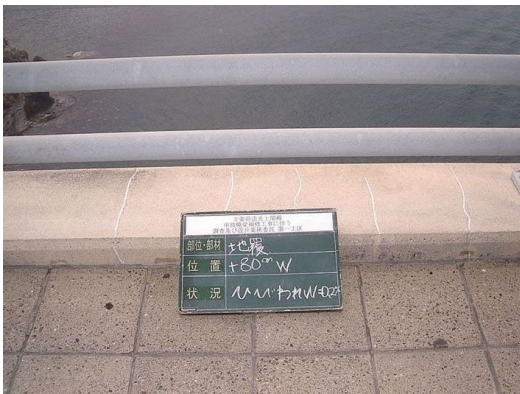
幅 0.1~0.2mm の橋軸直角方向ひびわれ A1-A2 間の東西側で、局部的に発生しており、発生箇所においては、等間隔(500mm 程度)に認められる。 【損傷ランクⅣ】
