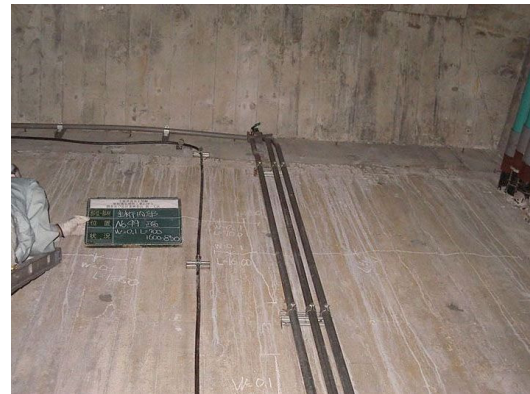
主に幅 0.1mm~0.5mm の横方向ひびわれ P2 柱頭部において、主に幅 0.1mm~0.5mm の横方向ひびわれが、局部的に認められる。【損傷ランク II】
