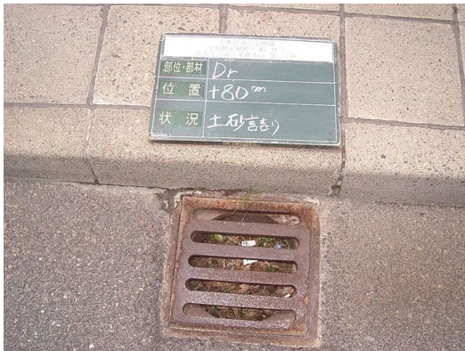
排水柵の土砂詰まり
