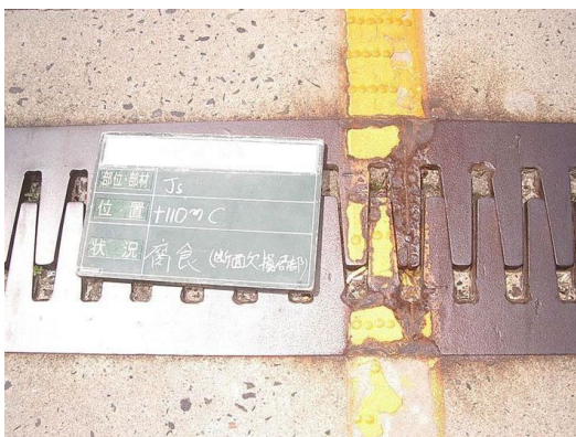
フェイスプレートの腐食
