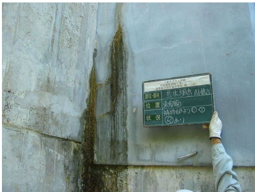
補修部の縦びわれからによる遊離石灰及び漏水 東側側面部のモルタル補修部において、縦ひびわれから遊離石灰及び漏水が認められる。【損傷ランクⅡ】
