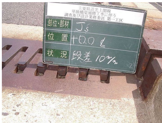
フィンガージョイントの段差 中央部フィンガージョイントの東西側において、10mmの段差が、認められる。【損傷ランクⅣ】
