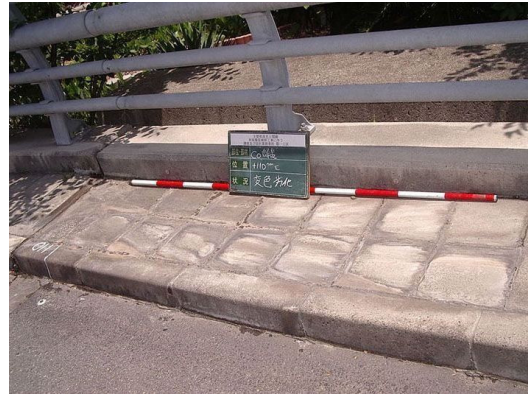
歩道部：化粧ブロックの変色、劣化 A2 東側歩道部の一部に認められる。 【損傷ランクⅣ】
