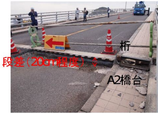
A2 橋台上の段差
