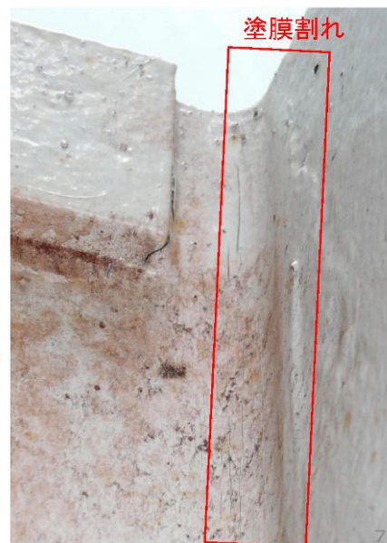
図 2.61 緊急外観調査で確認された事項 (その 5)
