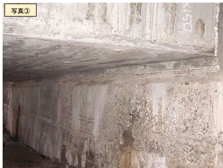
图 2.27 A2 橋台損傷写真
