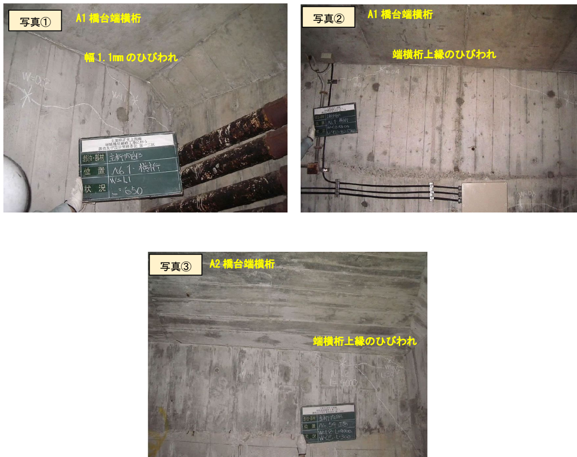
図 2.29 端横桁損傷写真
