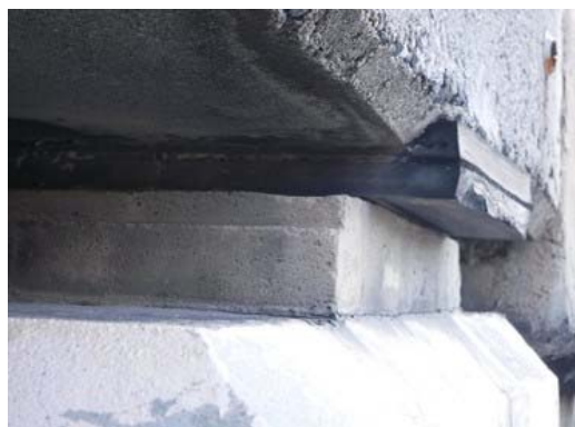
⑤ 部材 支承部 判定区分 I
