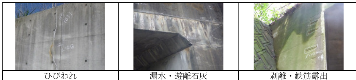
<ウイングの損傷状況>
