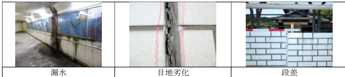
<継手の損傷状況>
