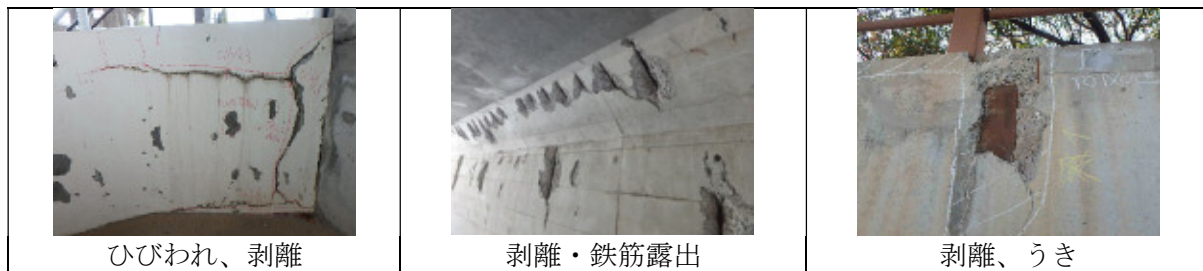
<本体ブロックの損傷状況>
