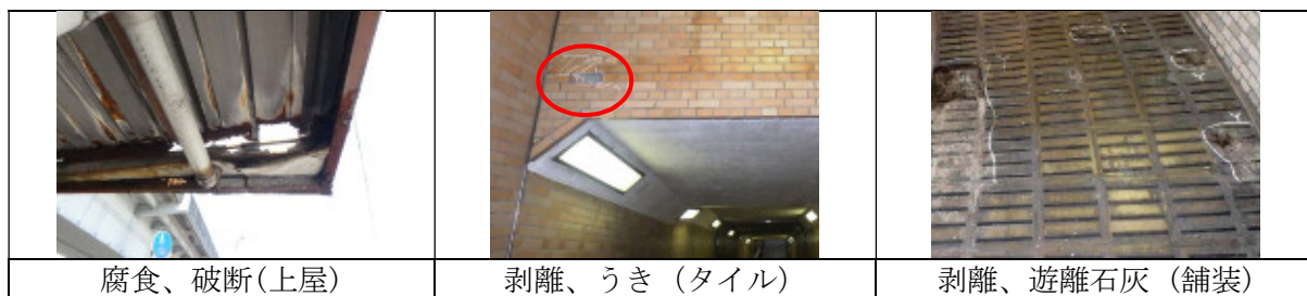
<その他の損傷状況>
