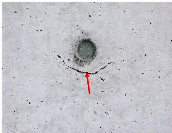
図 4.5.2 沈みひび割れ
