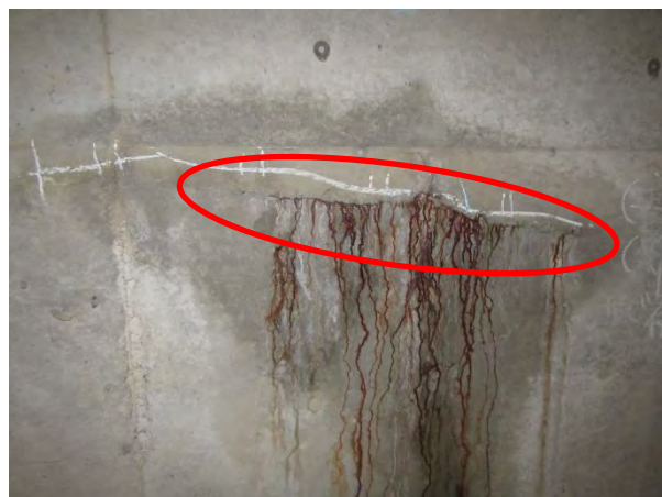
【コールドジョイント部からの漏水】
