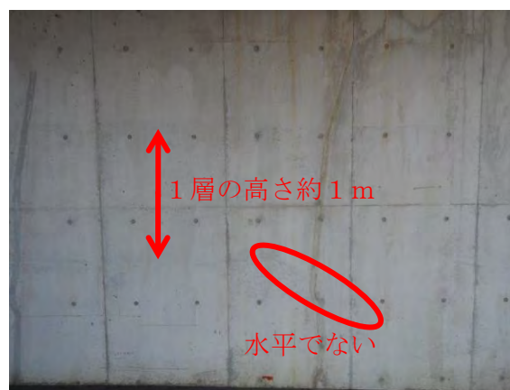
【適切でない打重ね線が認められる構造物】
