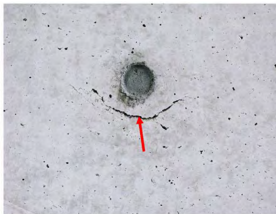
図 4.5.2 沈みひび割れ
