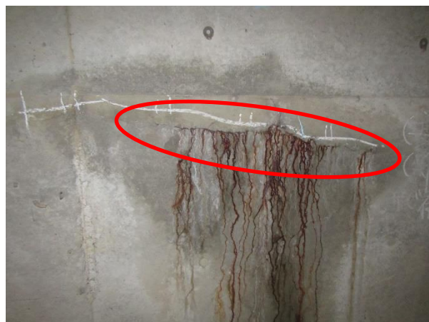
【コールドジョイント部からの漏水】
