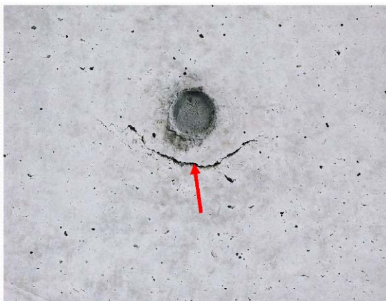
図 4.5.2 沈みひび割れ
