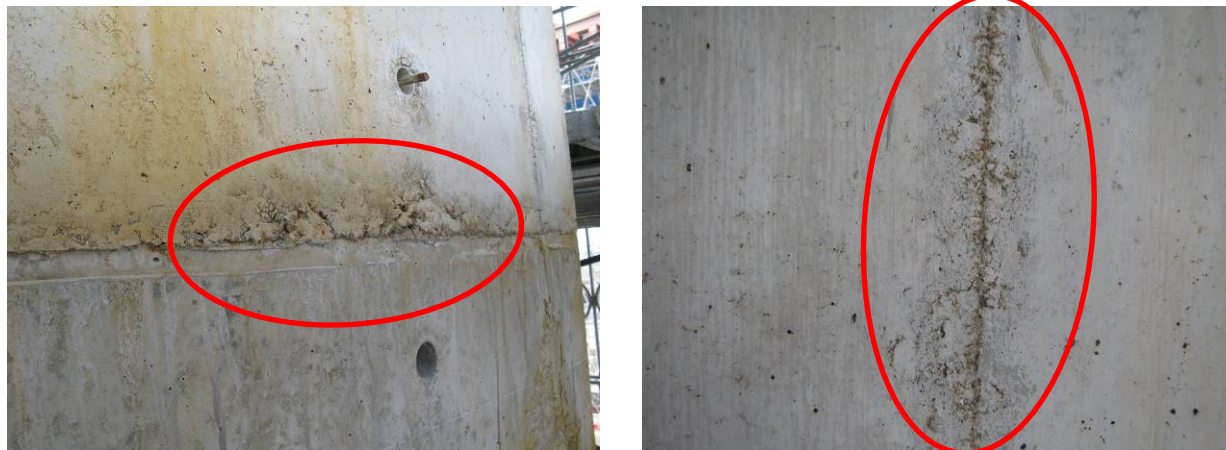
【型枠継ぎ目からのノロ漏れ】
