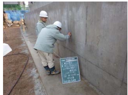
ひび割れ確認立会状況
