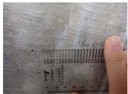
ひび割れ状況
