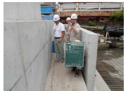
ひび割れ確認立会状況
