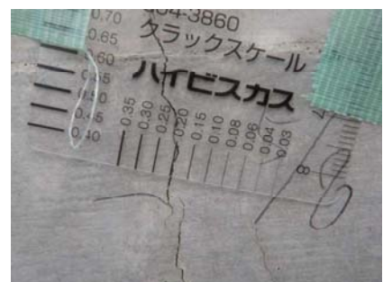
ひび割れ状況
