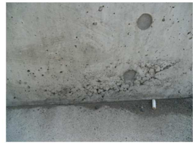
擁壁表面の豆板
