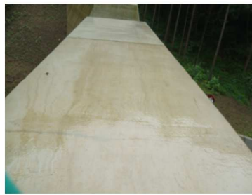
乾燥収縮ひび割れ
