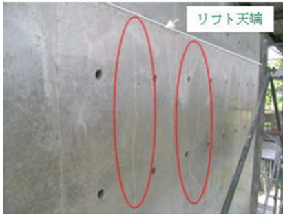
温度ひび割れ
