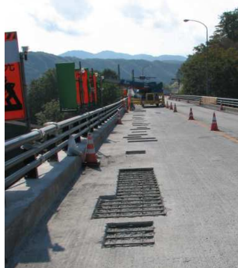
RC床版のうきを撤去した状況 走行軌跡に沿ってうきが発生している 鉄筋は腐食が始まっている
