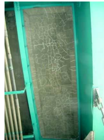
写真1-① R C床版の二方向ひび割れ
