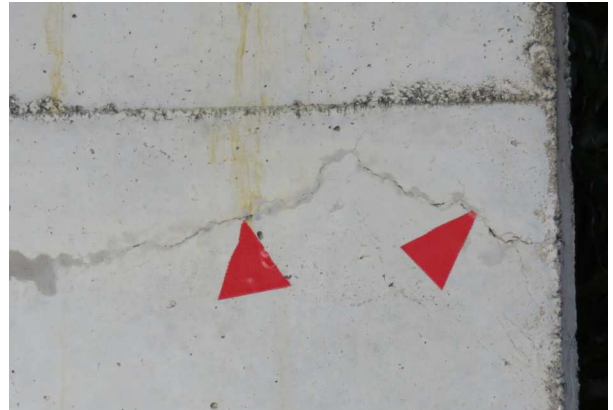
隅角部の沈みひび割れ
