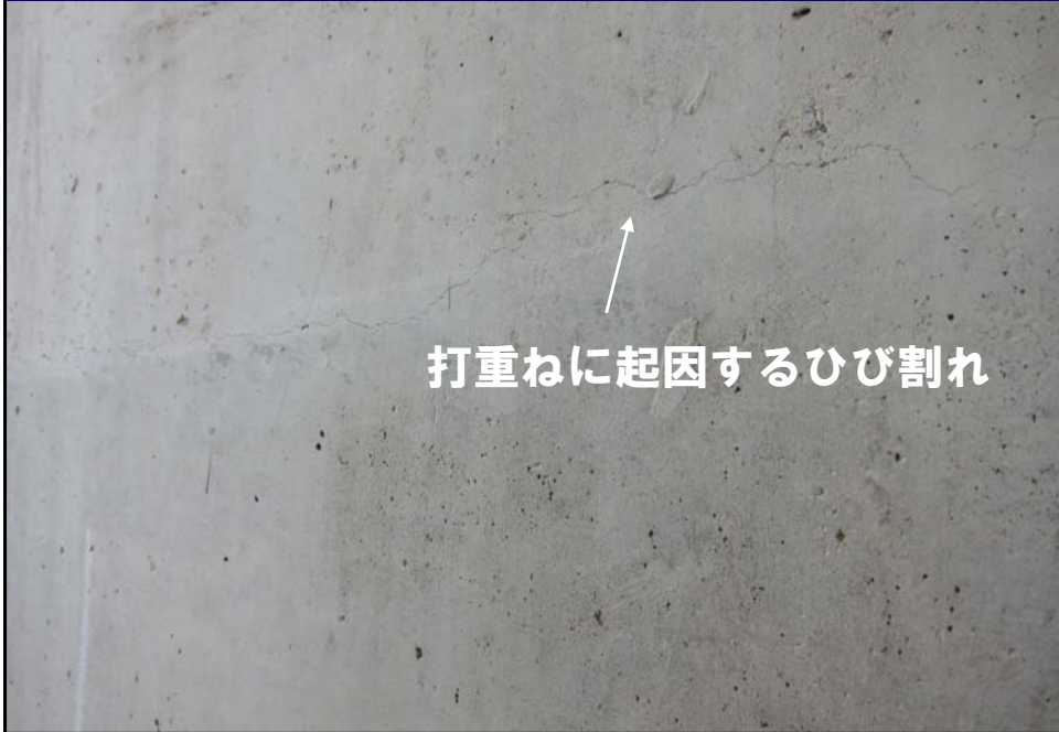
ひび割れ抑制対策前 橋台（流通センターIC）
