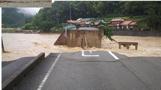
県道14号 高岩橋 護岸流失
