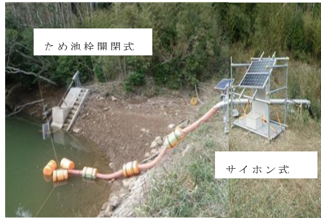
図4 自動排水システム設置状況
