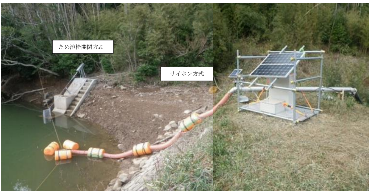
図6 自動排水システム設置状況
