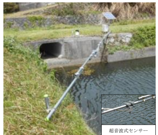
図3 遠隔監視システム設置状況(超音波式)
