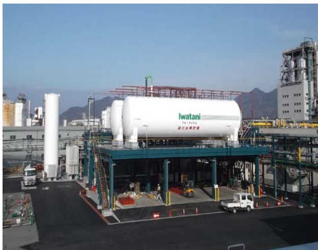
〔液化水素製造工場（周南市）〕
