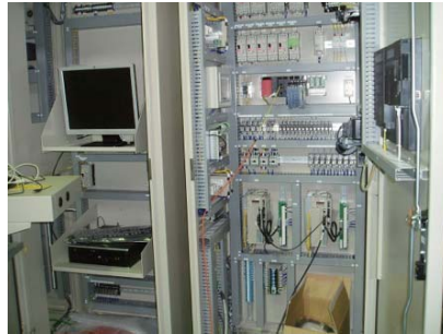
PC・PLC制御システム
