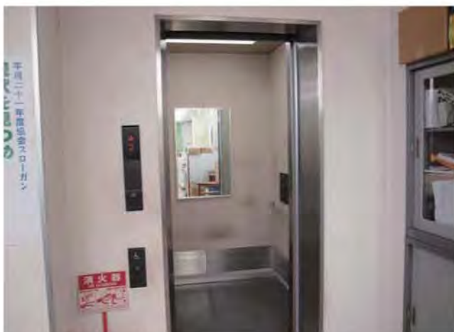
各棟にエレベーターが設置されている
