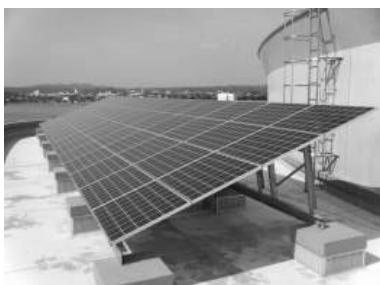
太陽光発電施設 (きらら博記念公園水泳プール)
