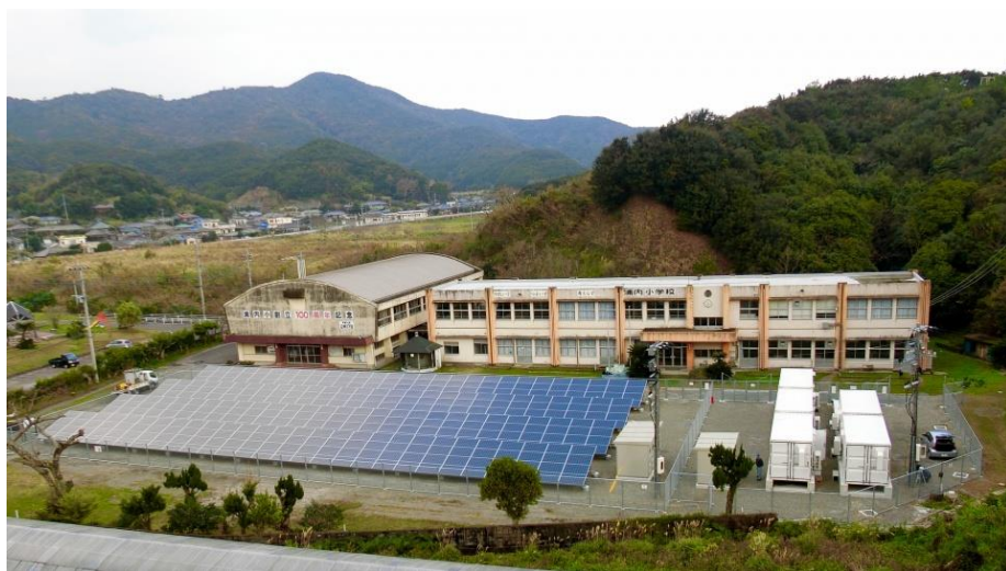
図表 2-16 薩摩川内市甕島でリユース蓄電池の実証事業のサイト(甕島・浦内太陽光発電所) 出典：「甕島蓄電センター／甕島・浦内太陽光発電所」次世代エネルギーウェブサイト、薩摩川内市 (https://jisedai-energy-satsumasendai.jp/ene-facility/6896/)
