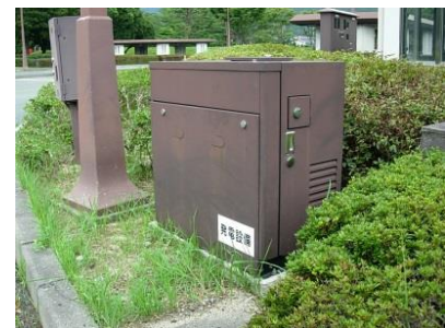
(非常用発電設備)
