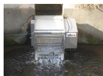
小水力発電施設
