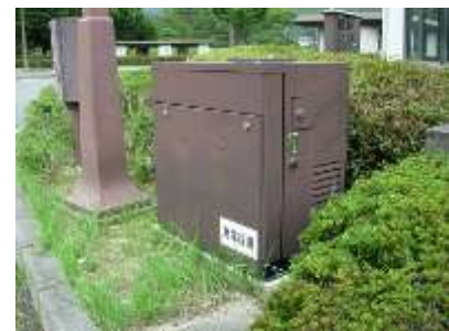
(非常用発電設備)
