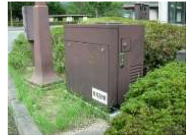
(非常用発電設備)
