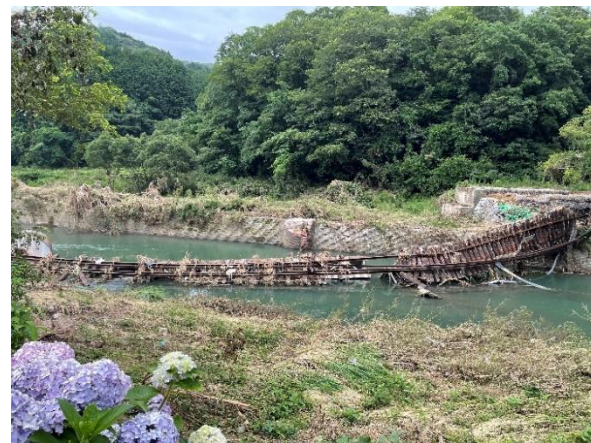
令和 5 年(2023 年)梅雨前線豪雨災害被害 (美祢市第 6 厚狭川橋梁)
