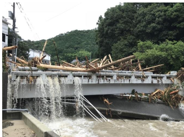
平成 30 年(2018 年) 7 月豪雨災害被害 (岩国市周東町瀬越)
