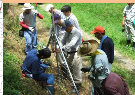
柵の破損部分を住民が修繕
