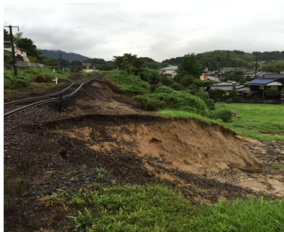
▽平成30年7月豪雨災害(被災箇所)
