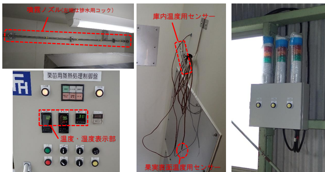
図 1-2 クリ用蒸熱処理機の細部(噴霧ノズル(左上。庫内)、制御盤(左下。庫外)、センサー(中央。庫内)、処理状況表示灯(右。庫外))
