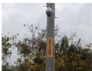
防犯カメラの設置
