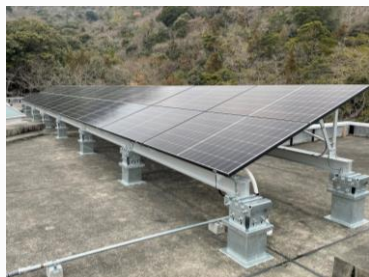
太陽光発電設備
