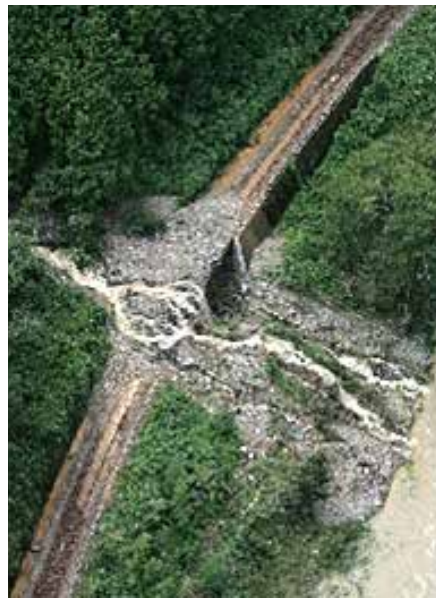
錦川鉄道の土砂崩れ
