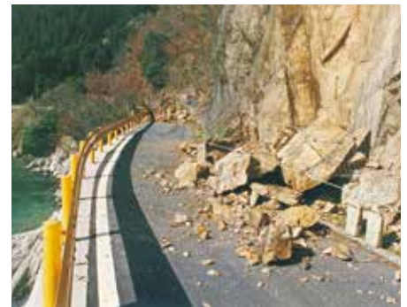
地震による被害
