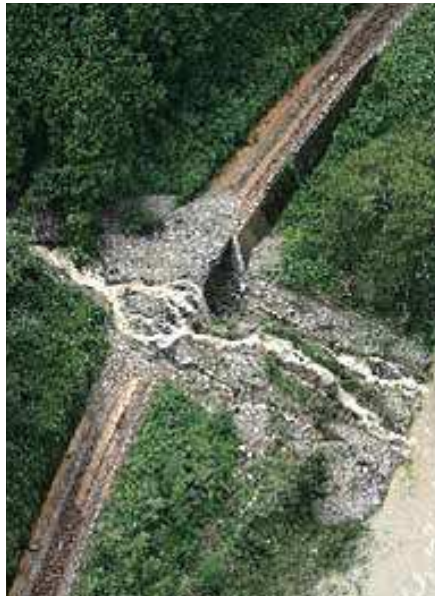
錦川鉄道の土砂崩れ
